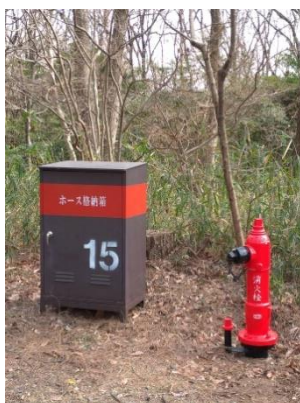
消火用ホース収納箱
