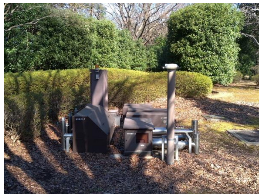
排水再利用装置制御盤
